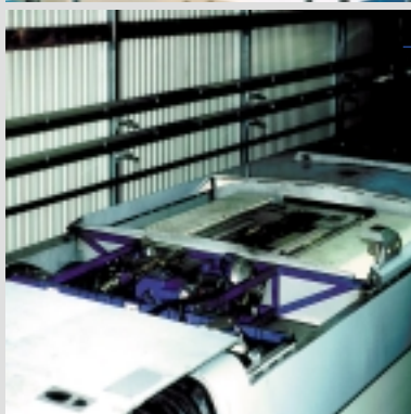
Hydraulikanlage auf Mittelwagen
